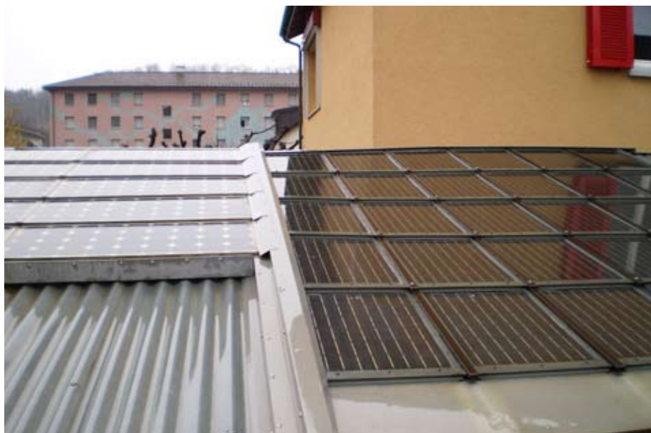
Eine der ersten Photovoltaik-Anlagen in Brugg steht bei Familie Gisiger an der Schilplinstrasse.
